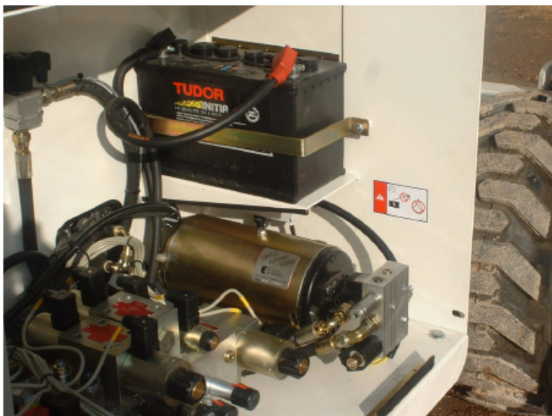
16. kép – Beépített generátor
